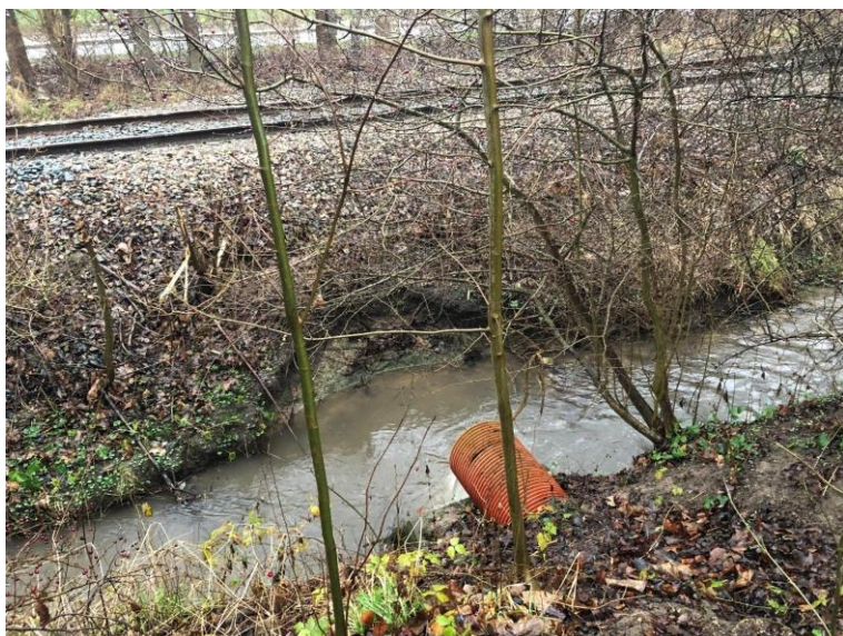
Figur 5 Udløb til Lejdebæk og erosion af banedæmning
