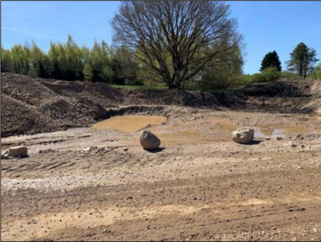
Foto 11: Vandhul til vanding af interne veje (Lokation C)
